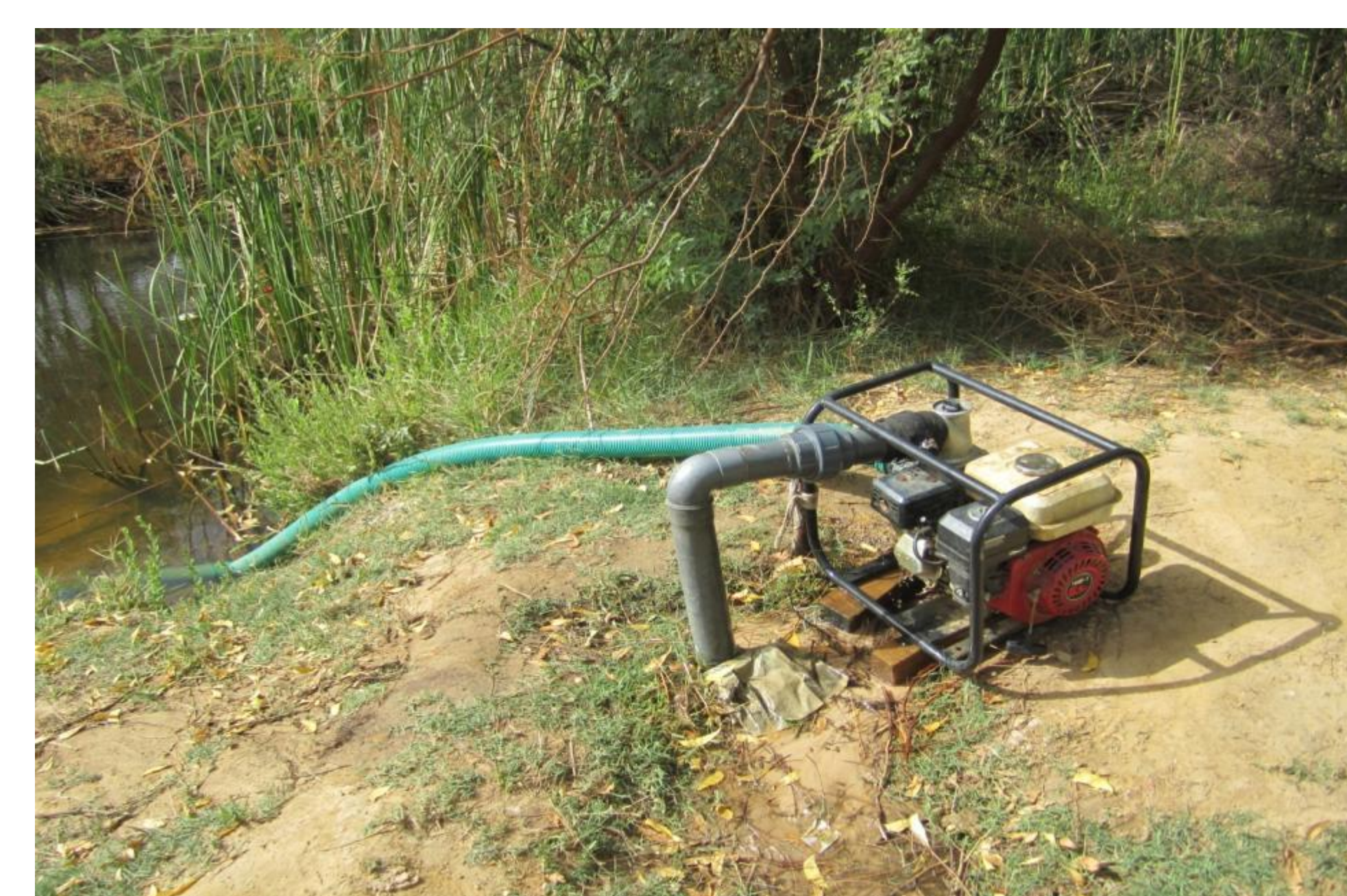
Fig. 6- Motopompe installée au bord du Chenal avec un démontage facile
